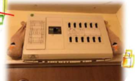
配電盤の周りに
